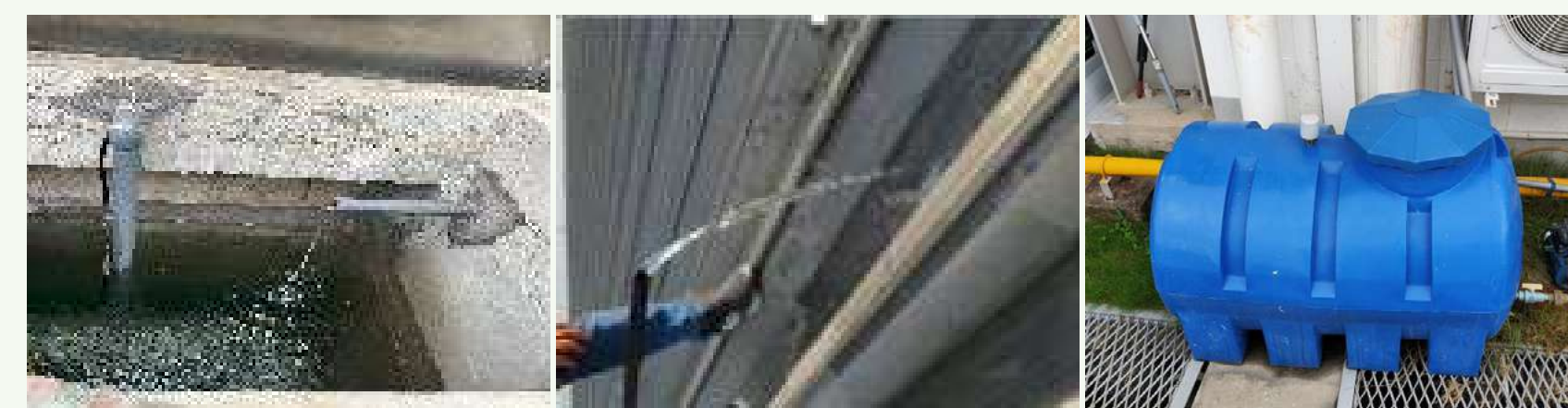
左圖 - 飲水機、空壓機、雨與玻璃清洗機排水匯流到 50 噸水池 / 中圖 - 夏天屋頂降溫 / 右圖 - 越南廠空調排放水回收裝置
